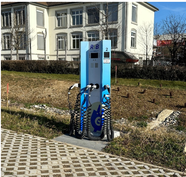
Ladestation Parkplatz Mitteläsch, Möriken
