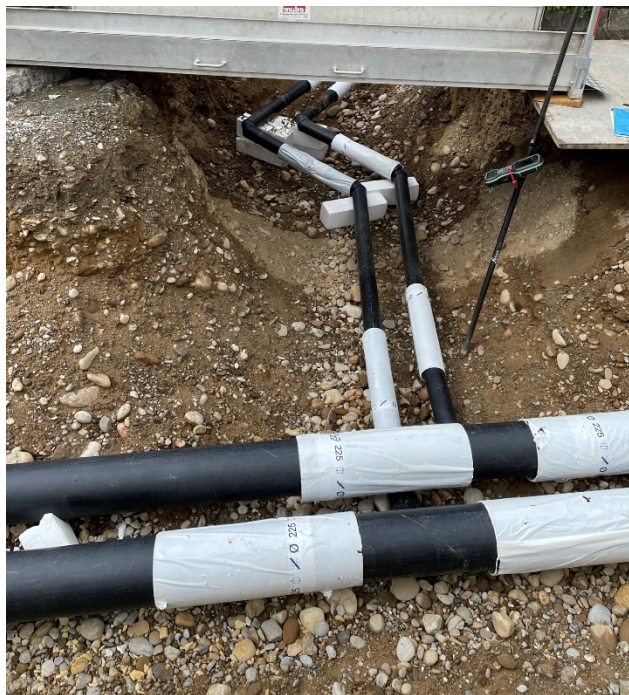
Hauptfernwärmeleitung mit Abgang Hausanschluss Schürlimatttrng
